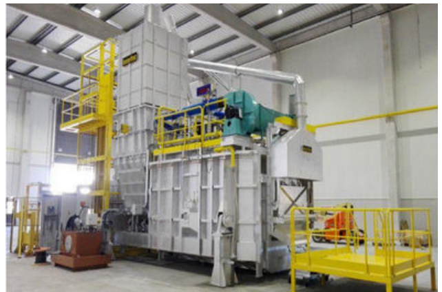
Forno Torre de Fusão
