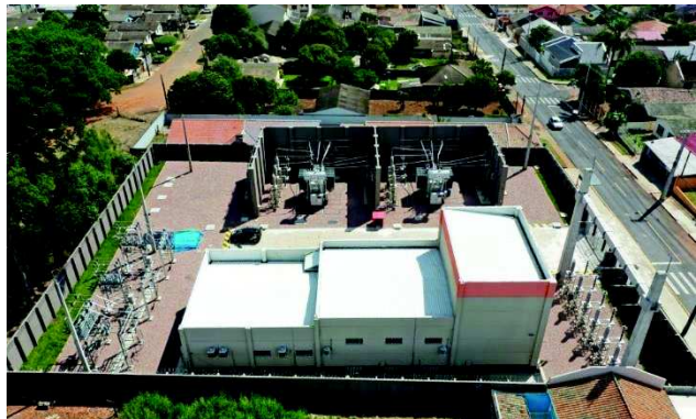
Foto: Subestação Léa Martins, em Ponta Grossa
